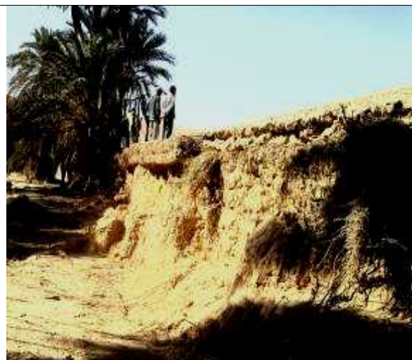
Digue de protection de l'oasis de Midès endommagée par les crues (vue de l'intérieur 2013)
