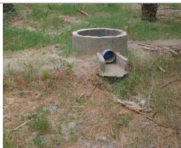
Photos 6 : Détérioration et abandon des infrastructures d'irrigation dans l'oasis de Tozeur
