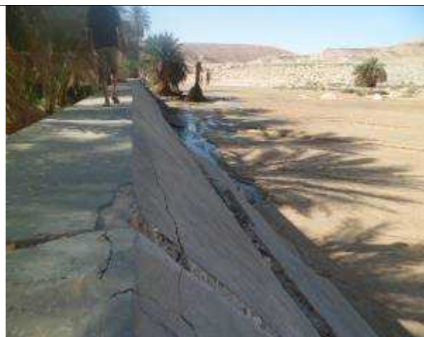
Digue de protection de l'oasis de Midès endommagée par les crues (vue de l'extérieur 2013)
