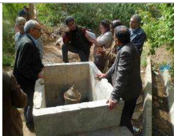
Photos 5 : Infrastructures d'irrigation en abandon dans l'oasis de Tozeur
