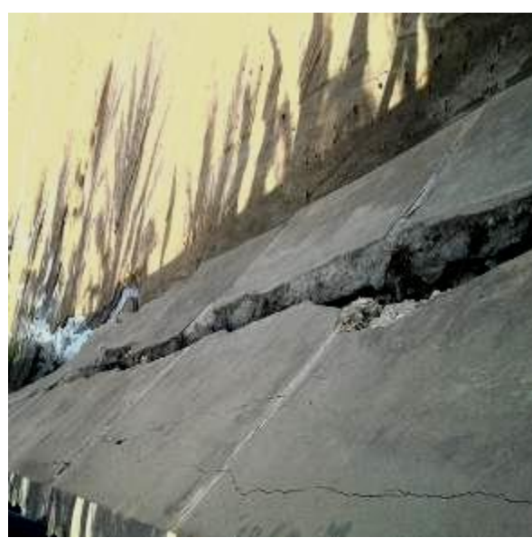
Vue de la digue endommagée (côté oued) par les inondations de 2012
