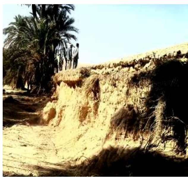
Vue (côté oasis) de la digue endommagée par les inondations de 2012
